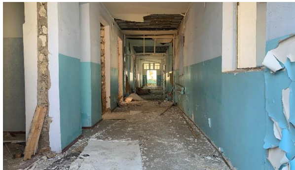
Zerstörter Labor- und Untersuchungstrakt
